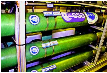
Unités de traitement des eaux grises Station CONCORDIA
